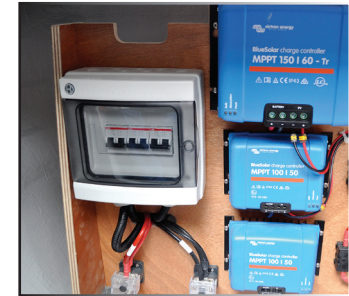
DISYUNTORES DE LOS PANELES SOLARES
