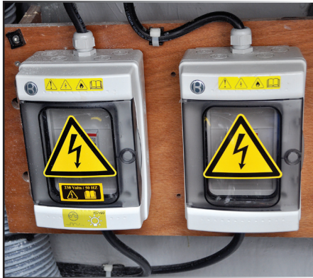
DISYUNTORES DE TOMA DE MUELLE
