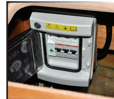
DISYUNTORES DE LOS ELEMENTOS DE CLIMATIZACIÓN
