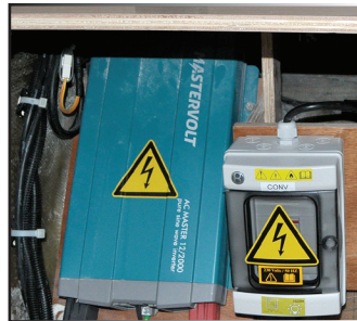
CONVERTIDOR + DISYUNTOR DEL CONVERTIDOR
