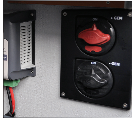
CORTACIRCUITOS DEL GENERADOR
