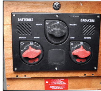
CORTACIRCUITOS MOTOR ESTRIBOR + BORDO
