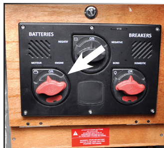
CORTACIRCUITOS MOTOR ESTRIBOR
