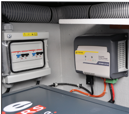
DISYUNTORES + CARGADOR DEL GENERADOR
