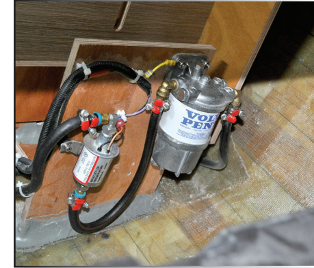
FILTRO DE GASOIL DEL GENERADOR
