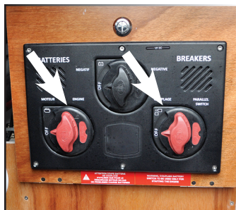
CORTACIRCUITOS MOTOR BABOR + ACOPLAMIENTO BATERÍAS
