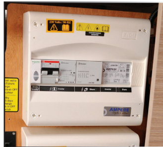
DISYUNTOR DEL CONVERTIDOR
