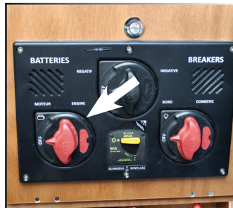
CORTACIRCUITOS MOTOR ESTRIBOR
