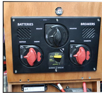
DISYUNTORES A BORDO, MOTOR ESTRIBOR Y PANELES SOLARES
