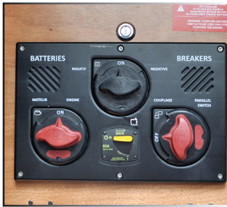
DISYUNTORES DE ACOPLAMIENTO DE BATERÍAS, MOTOR BAVOR Y DESALINIZADORA
