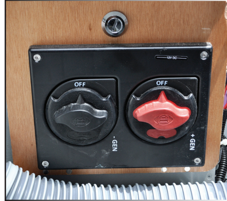
CORTACIRCUITOS DEL GENERADOR
