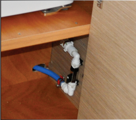
VANNE D'ALIMENTATION EN EAU DOUCE
