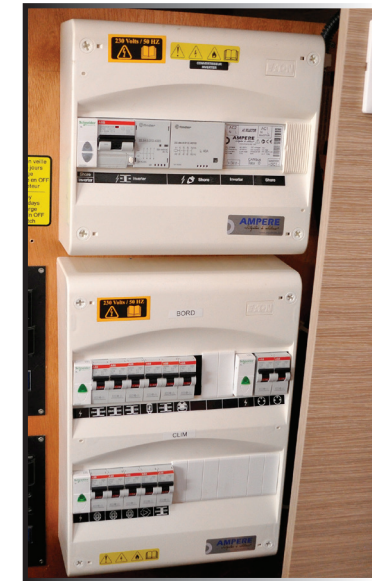
DISJONCTEURS DES CONSOMMATEURS
