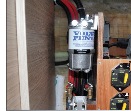
FILTRE A GASOIL DU GENERATEUR
