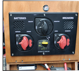
COUPE-CIRCUITS BORD, MOTEUR TRIBORD ET PANNÉAUX SOLAIRES
