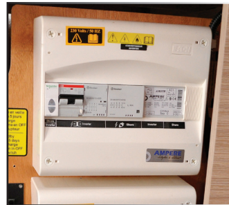
DISJONCTEUR DE CONVERTISSEUR
