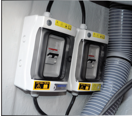
DISJONCTEURS PRISES DE QUAÏ
