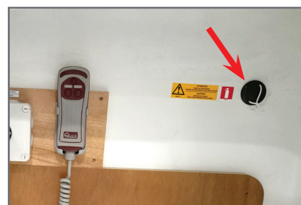
Acceso al tapón del compartimiento generador
