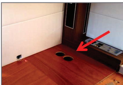
Alimentation carburant moteur et générateur
