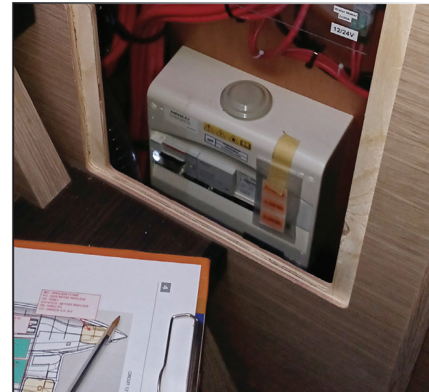
CIRCUIT BREAKER 12 V / 220 V - 2000 VA INVERTER
