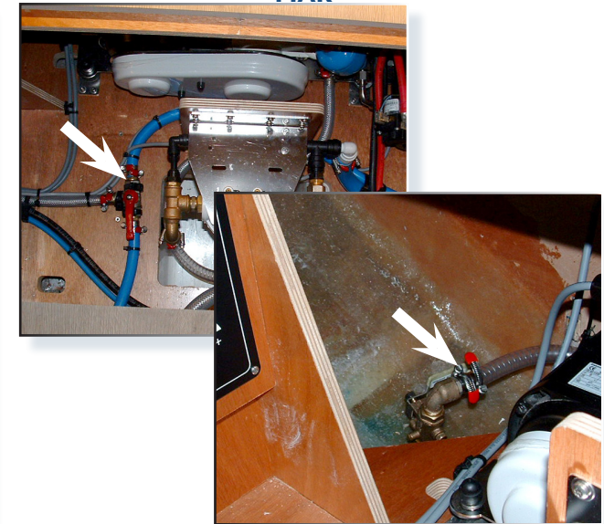
VÁLVULA TRES VÍAS + VÁLVULA DE ALIMENTACIÓN DE AGUA DE MAR
