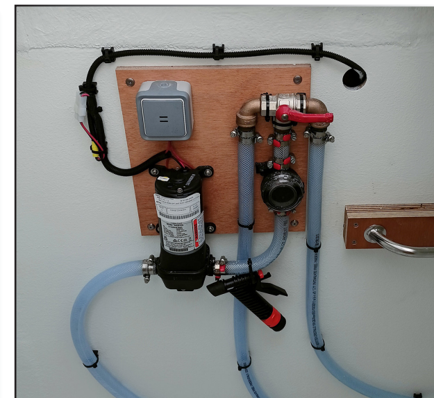
BOMBA DE LAVADO DE CUBIERTA
