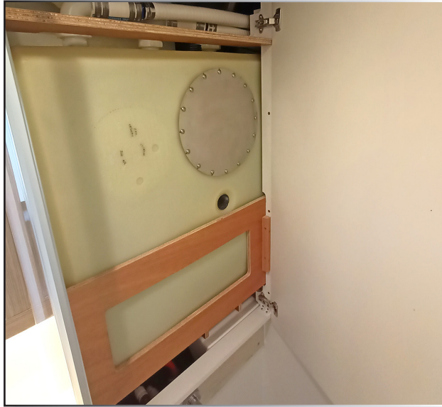
DEPÓSITO DE AGUAS NEGRAS
