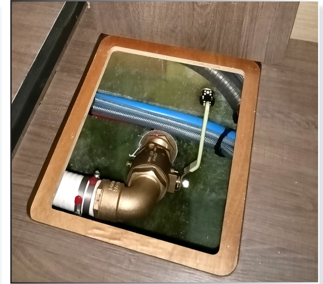
VÁLVULAS DE EVACUACIÓN AL MAR
