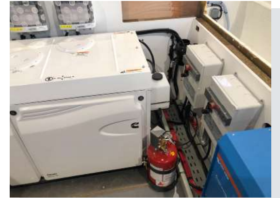
Extintor compartimento generador
