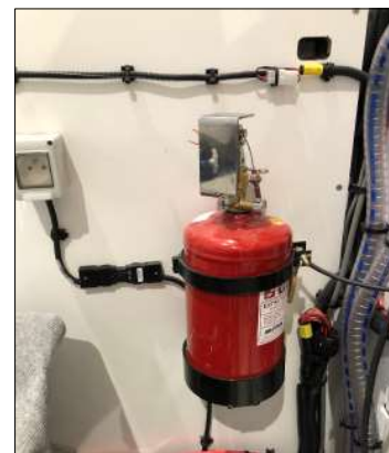
Extincteur de cale moteur
