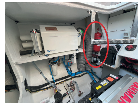
Extincteur du local moteur tribord
