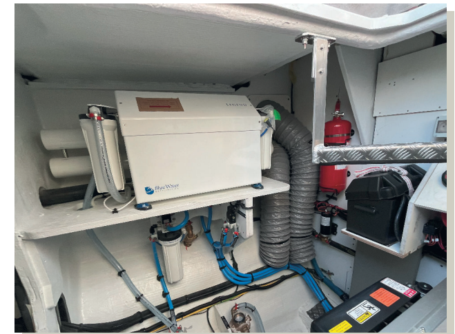
9 LOCAL MOTEUR TRIBORD
