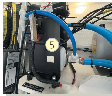
LOCAL MOTEUR TRIBORD
