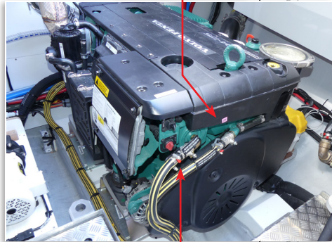
Connexions Liquide Refroidissement Moteurs vers Chauffe-Eau
