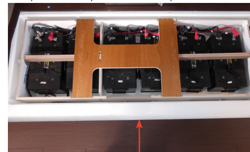
Groupe Batteries 630Ah = 6 x 12V-210Ah Batteries Gel sous le Plancher Table Salon
