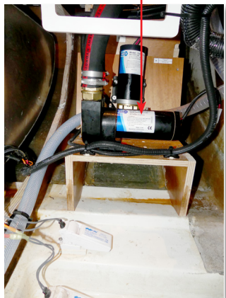
Pompe de Transfert P02
