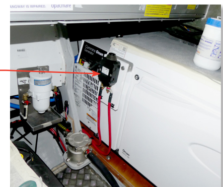
Batterie Générateur BB et Coupe-batterie K29
