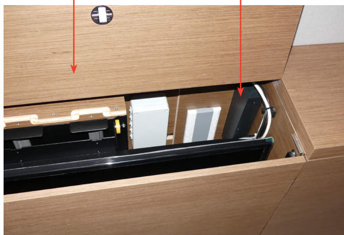
Amplificateur Monozone ATOLL dans Placard Latéral Avant (Cabine Propriétaire)
