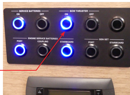
Commandes Alimentation Circuit Propulseur
