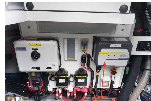
Chargeur Batteries Moteur & Générateur Bâbord
