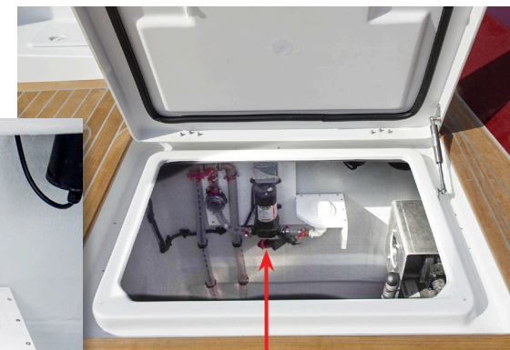
Pompe de Lavage de Pont dans le Coffre du Pont Avant Bâbord
