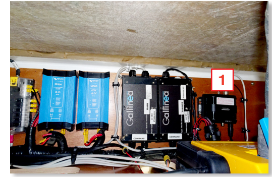
Convertisseurs 12/24V et Régulateurs Électroniques dans le Plafond du Salon (bâbord)
