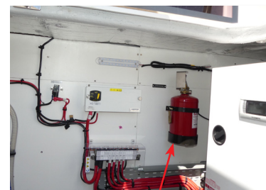
Extincteur Compartment Moteur Actionné à Distance
