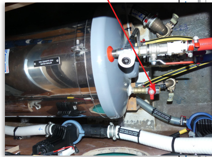
Passe-coque & Vanne Rejet Mer Réservoir Arrière
