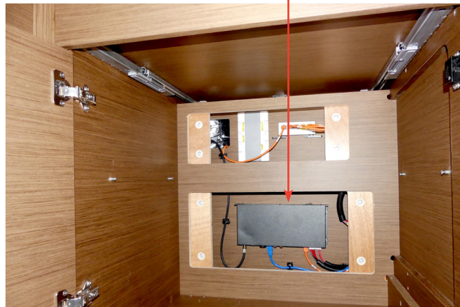
Amplificateur Atoll dans Placard Latéral Arrière Cabine Équipage
