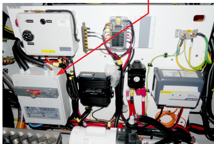
Sélecteur STANDARD S02 Quai 63A <> Générateur Tribord (1 seul genset)
