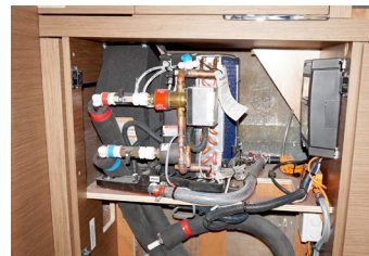
Assemblage Typique d'une Unité A/C : AU-HV
