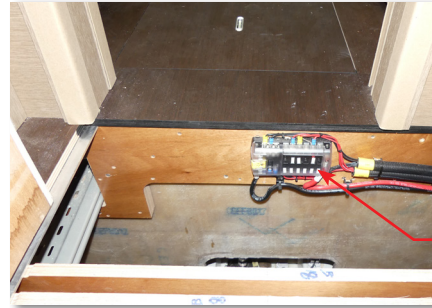
Bloc Fusibles X08 Bâbord
