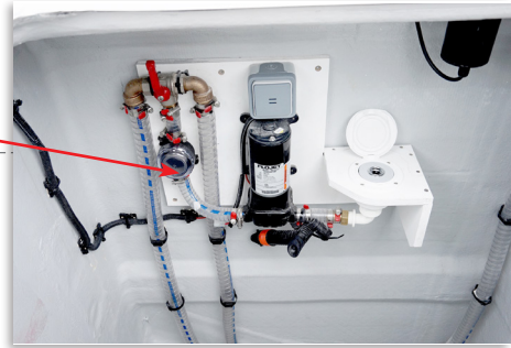
Alimentation Eau Douce Pompe de Lavage
